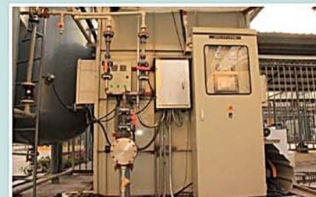
传化集团污水处理实证 伝化集团廃水処理実証
